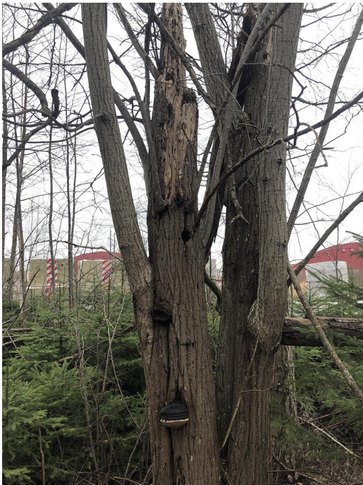
Figur 9. ID 25, sälk med hålighetr och sprickor med värde 2.
