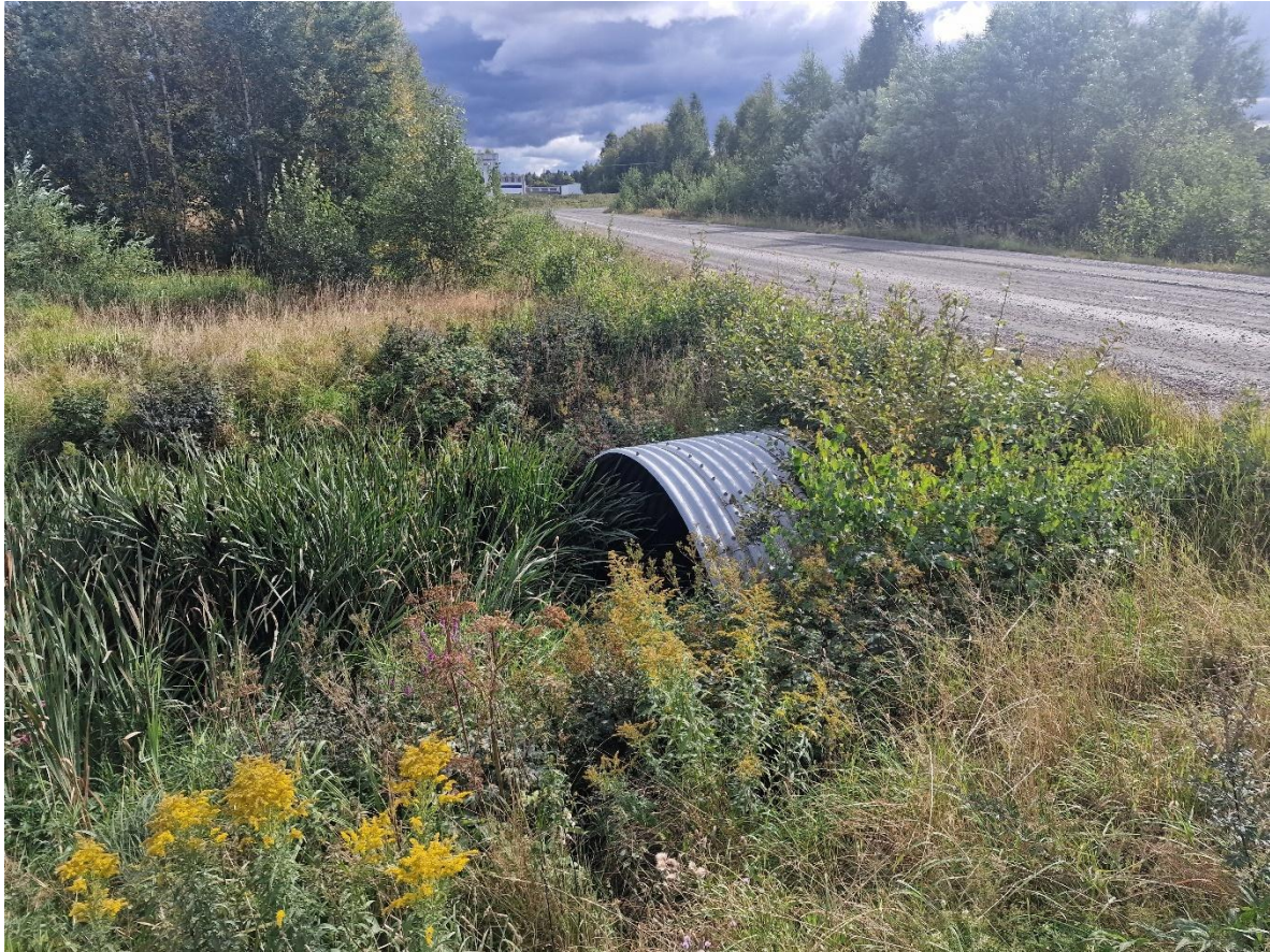
Figur 3: Stor dagvattentrumma där Silån/Göteneån leds under Miljövägen. (Foto från platsbesök augusti 2025)
