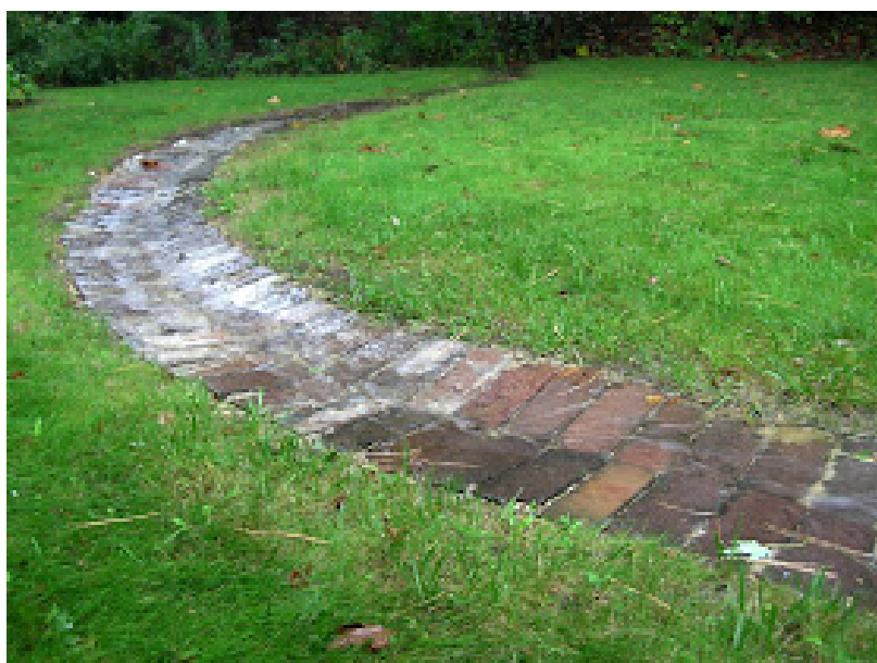
Figur 7b: en dagvattenränna belagd med gatstenar
